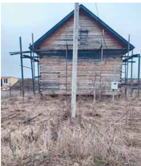
Фото: прокуратура Тверской области
